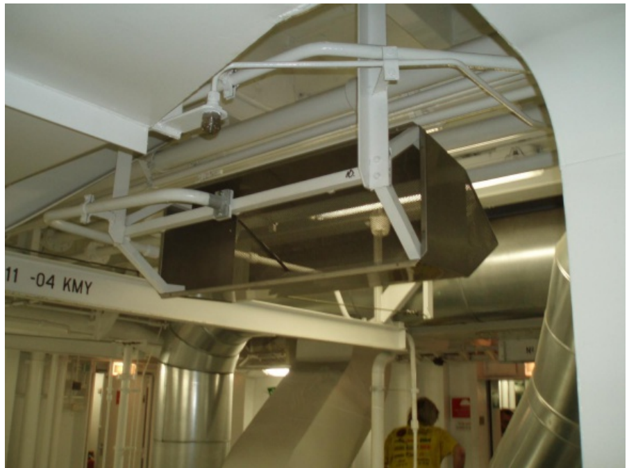
Wassersprühnebelanlage und Schaum löschen Maschinenbrände ohne CO 2
