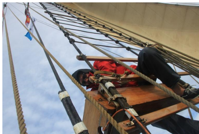
Wie der Affe auf dem Schleifstein: Der Elektriker auf der Positionslaterne
